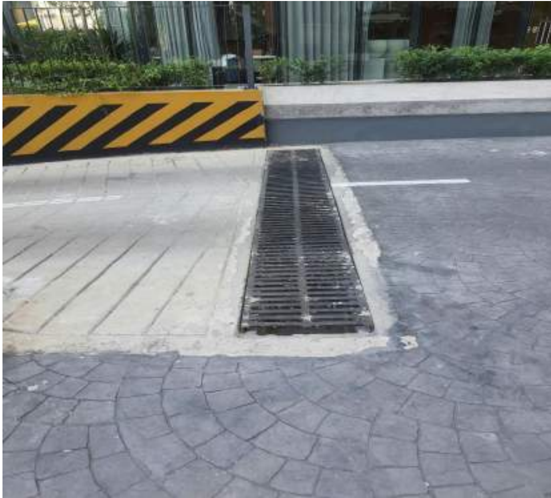
Hình 5. Hình ảnh rãnh thu nước mưa chảy tràn của cơ sở
