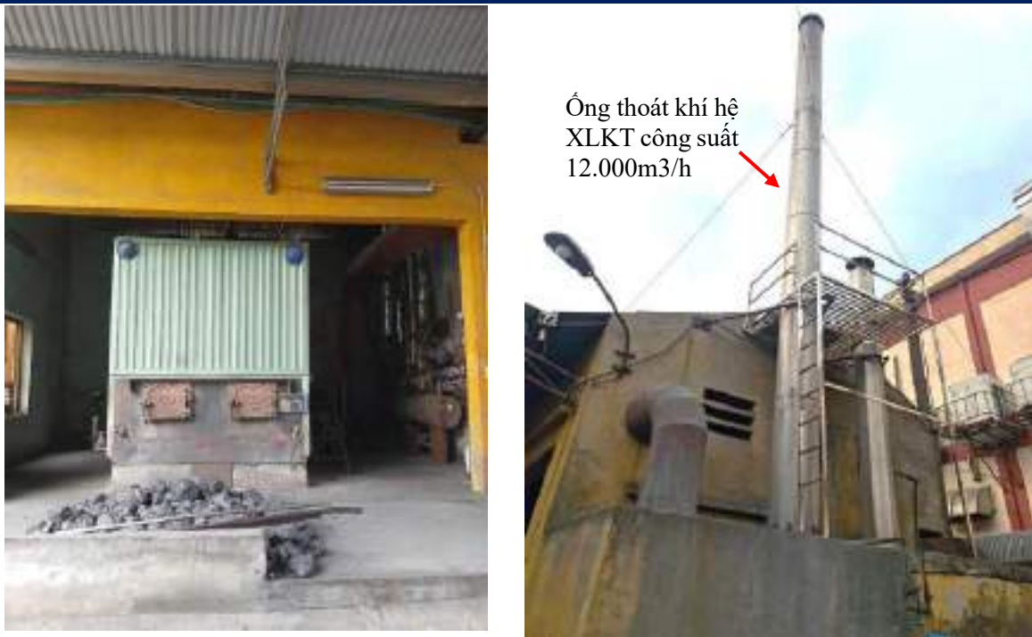
Hình ảnh lò hơi đang sử dụng và thiết bị xử lý khí thải Hình 3. 9. Một số hình ảnh tại hệ thống xử lý khí thải lò hơi
