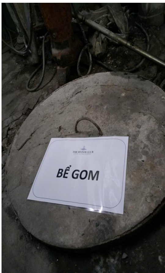
Bể gom nước thải
