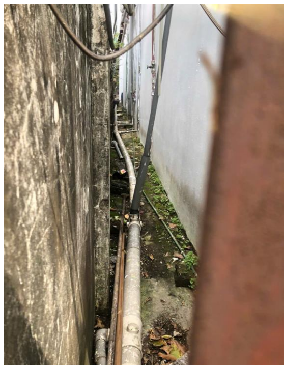
Đường ống thu gom nước mưa mái
