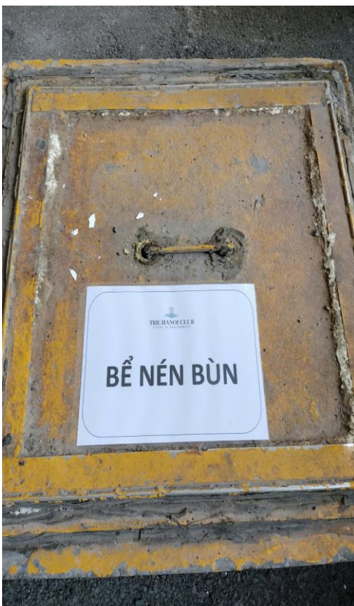
Bể nén bùn
