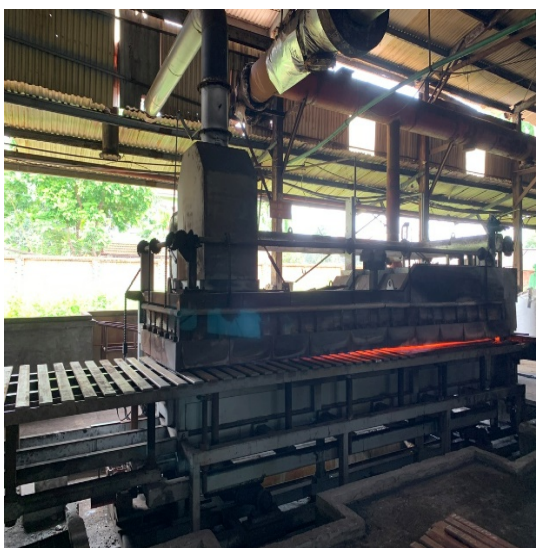
Phễu thu, thiết bị xử lý lò cán 1
