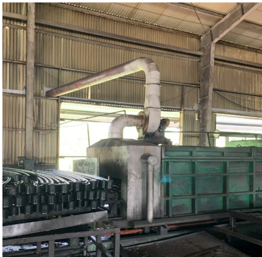
Phễu thu, thiết bị xử lý lò ram 2
