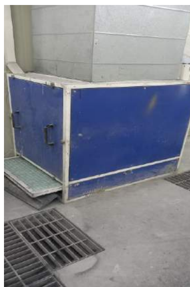
Bông lọc bụi thủy tinh tại đường ống thoát khí
