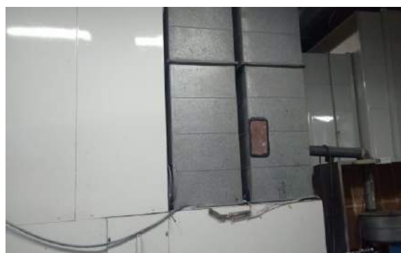
Đường thoát khí
