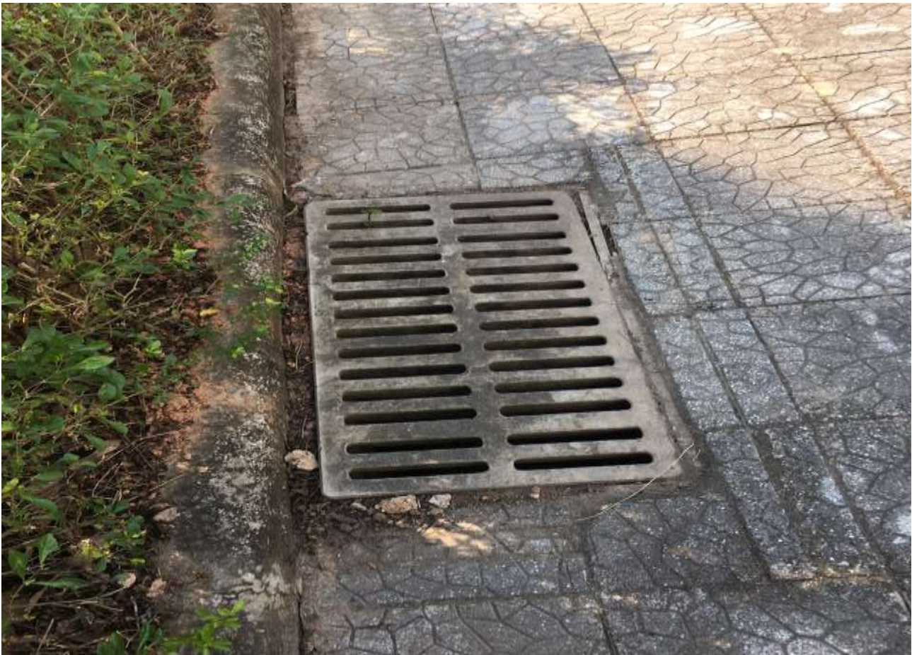
Hình 3.2. Cống thoát nước mưa của Cơ sở
