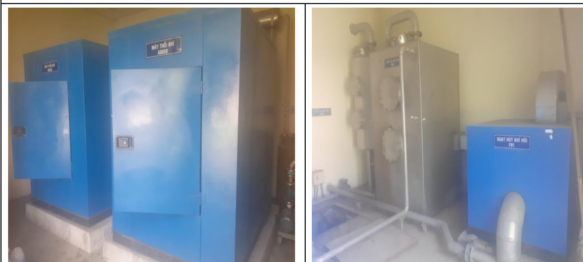
Các thiết bị trạm xử lý nước thải 700 m 3 /ngày đêm
