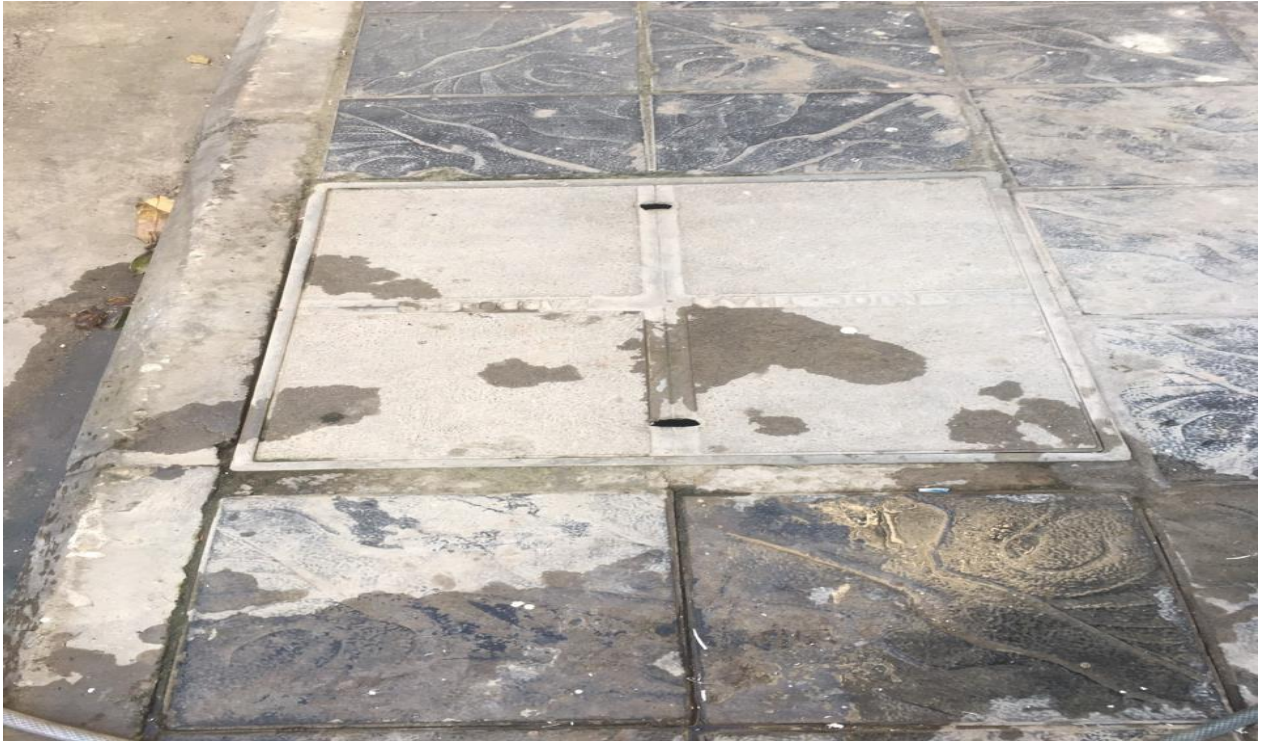
Hố ga thu nước thải khu nhà thấp tầng
