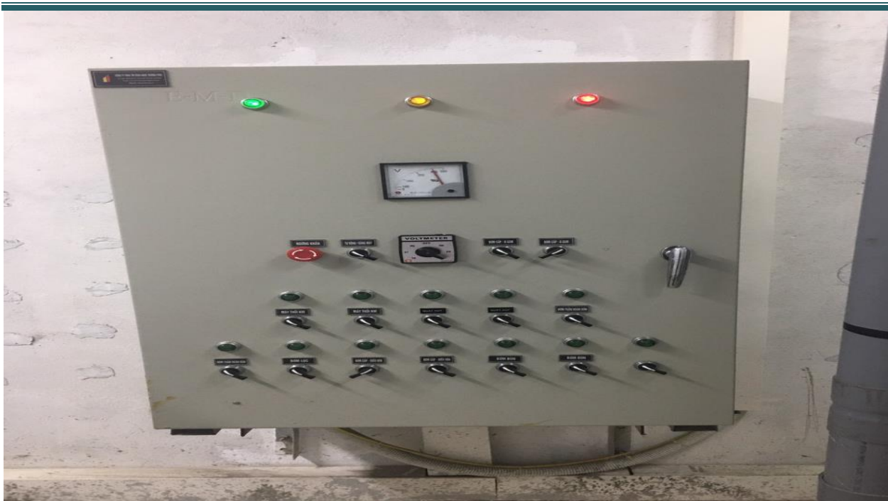
Máy móc, thiết bị của hệ thống xử lý
