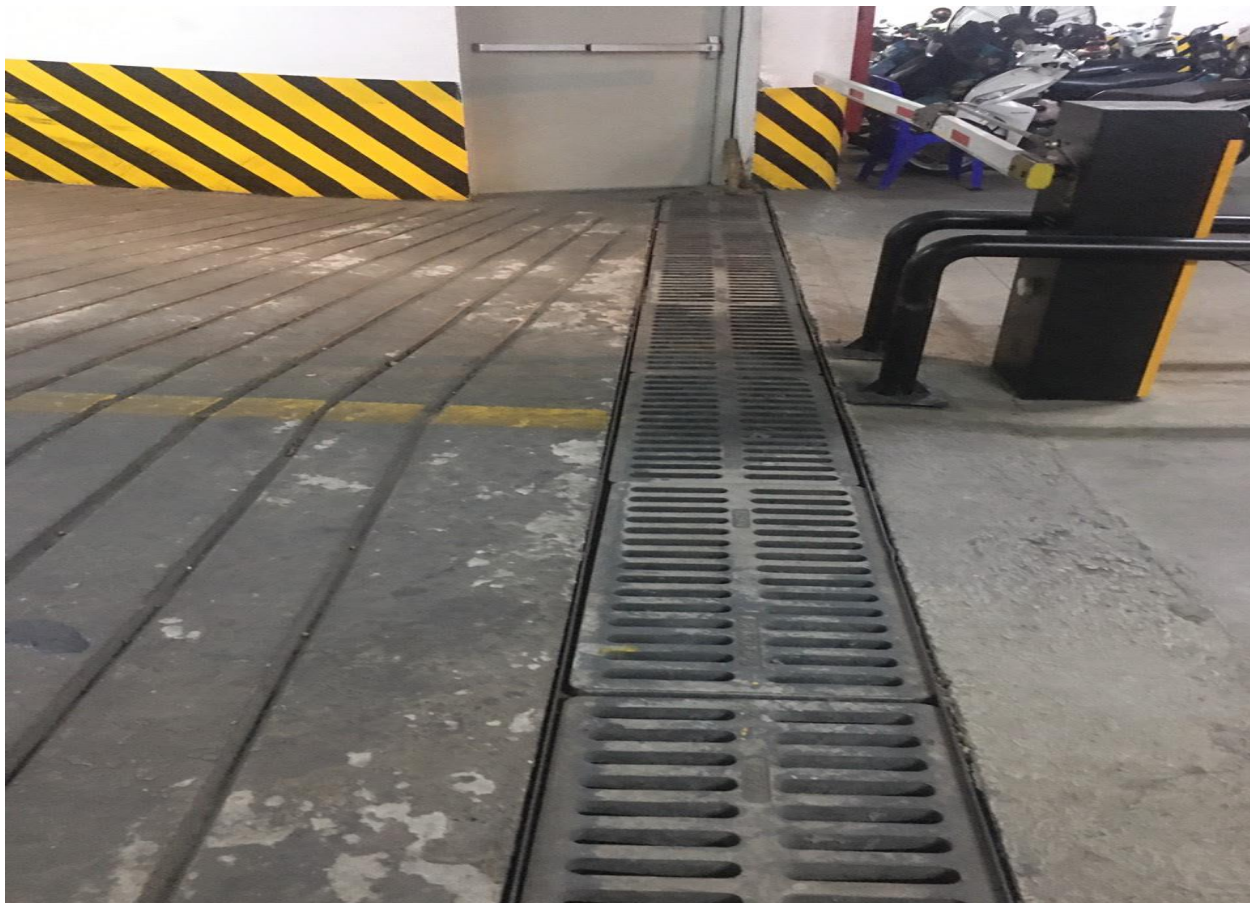
Cống thu nước mưa sàn tầng hầm khu nhà cao tầng
