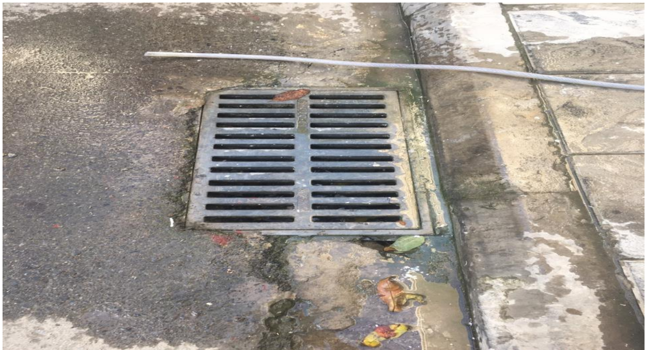
Cống thu nước mưa ngoài nhà khu cao tầng
