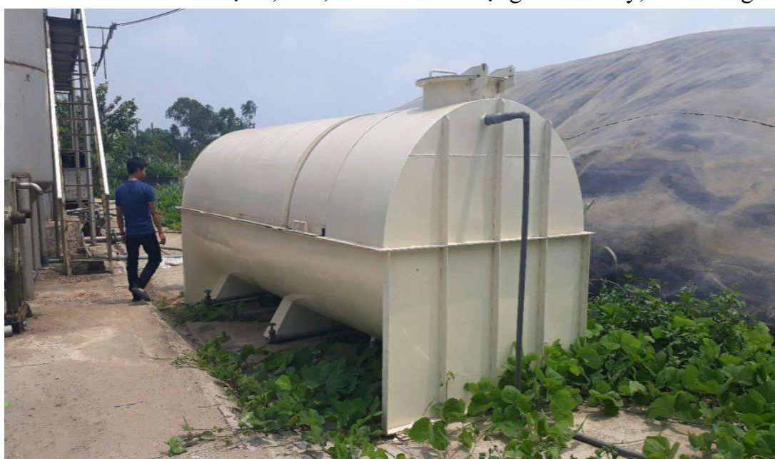
Hình 4. 5. Hình ảnh thực tế hệ thống XLNT công nghệ D-VIC
