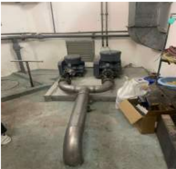
Bể xử lý
