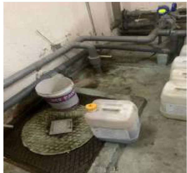
Bể xử lý
