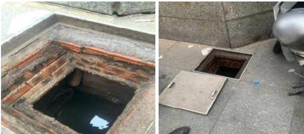
Hình 3. 5. Hồ ga thoát nước thải sau xử lý của cơ sở
