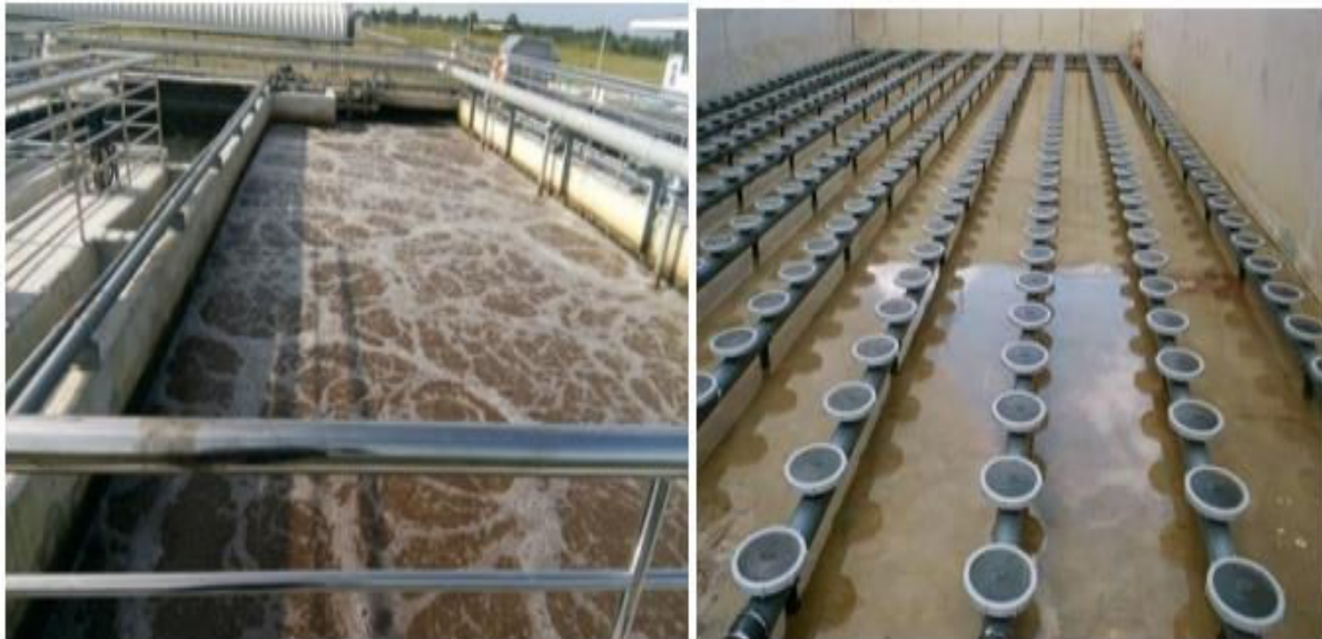
Hình 4.9. Hình bể hiếu khí và hệ thống phân phối khí tại bể
