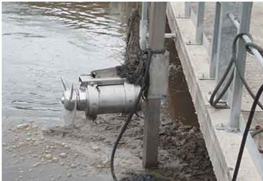
Hình 4.8. Hình ảnh bể thiếu khí và máy khuấy chìm
