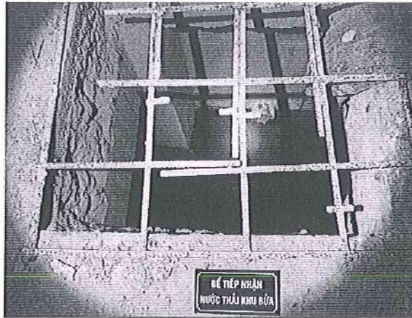
Hình ảnh bể tiếp nhận nước thải khu rửa
