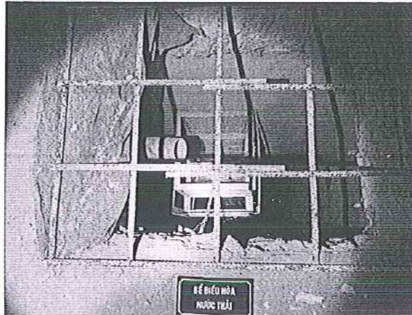
Hình ảnh bể điều hòa nước thải
