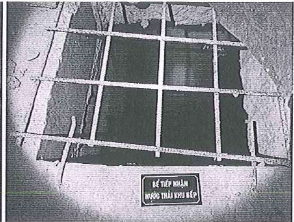
Hình ảnh bể tiếp nhận nước thải khu bếp
