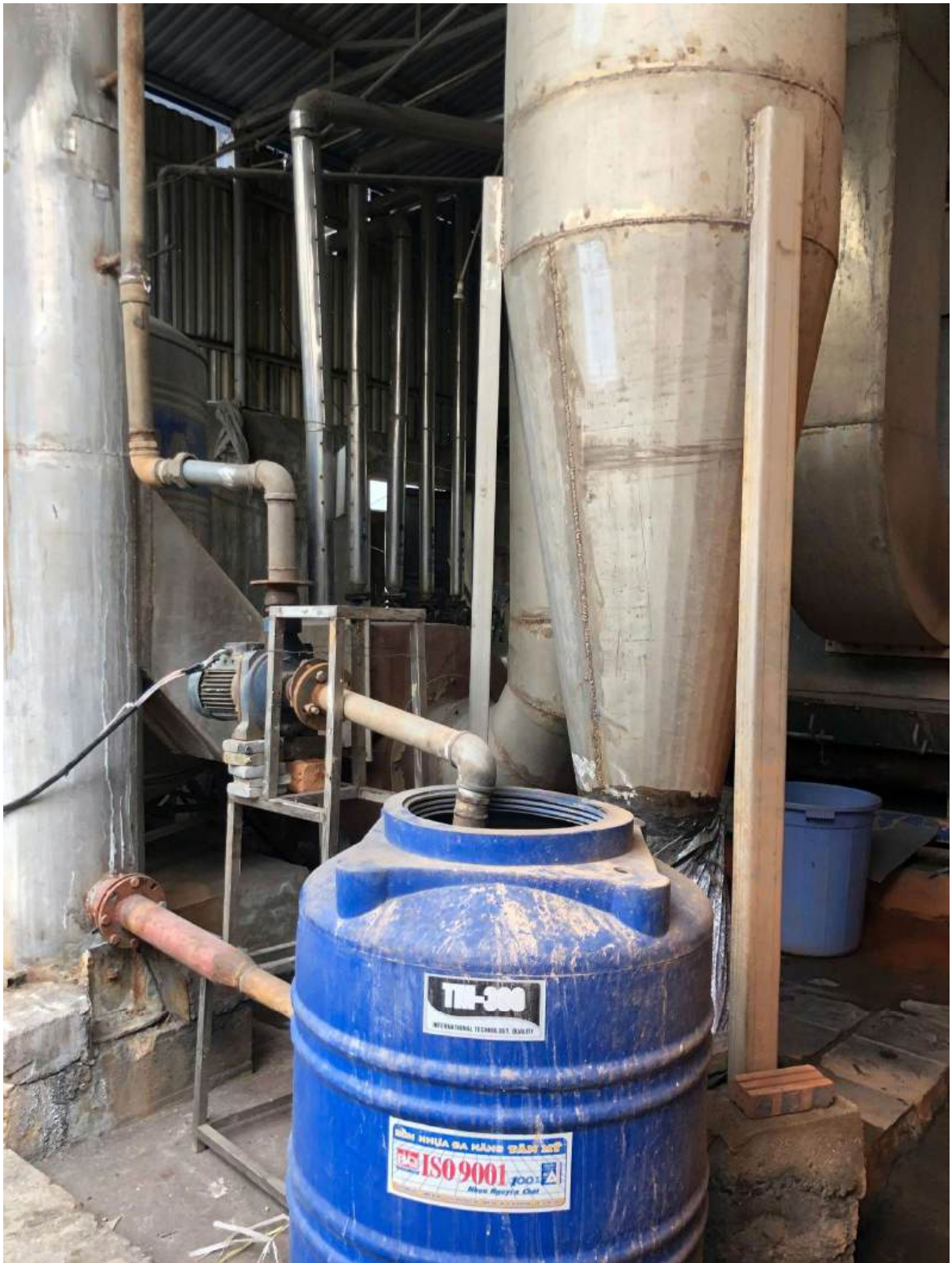
Hình 3. 12. Hệ thống xử lý khí thải lò hơi tại cơ sở
