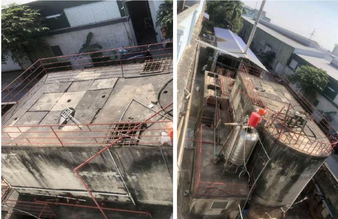
Hình 3. 10. Hệ thống xử lý nước thải 50m 3 /ngày đêm
