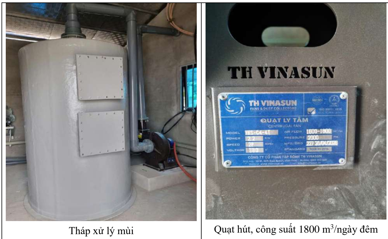
Hình 3.6. Một số hình ảnh trạm hệ thống xử lý mùi
