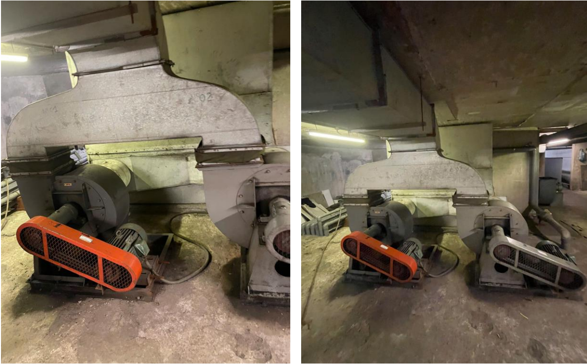
Hình 3. 7. Hình ảnh hệ thống xử lý mùi từ trạm XLNT
