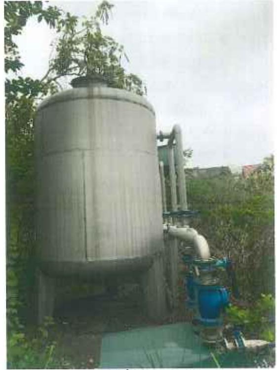
Bồn lọc áp lực
