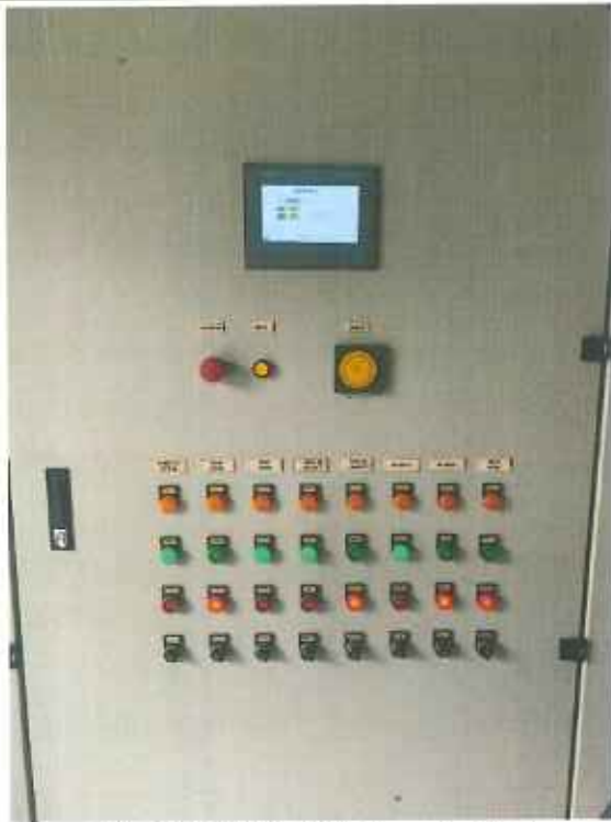
Tủ điều khiển HTXL nước thải
