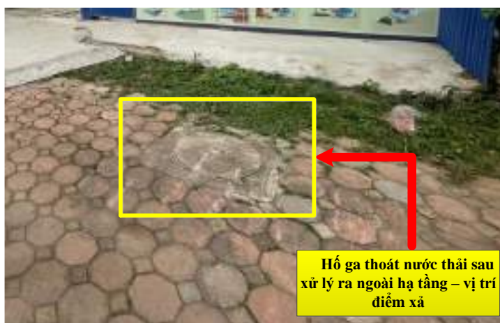
Hình 3.4: Hố ga thoát nước thải sau xử lý ra ngoài hạ tầng của KĐT
