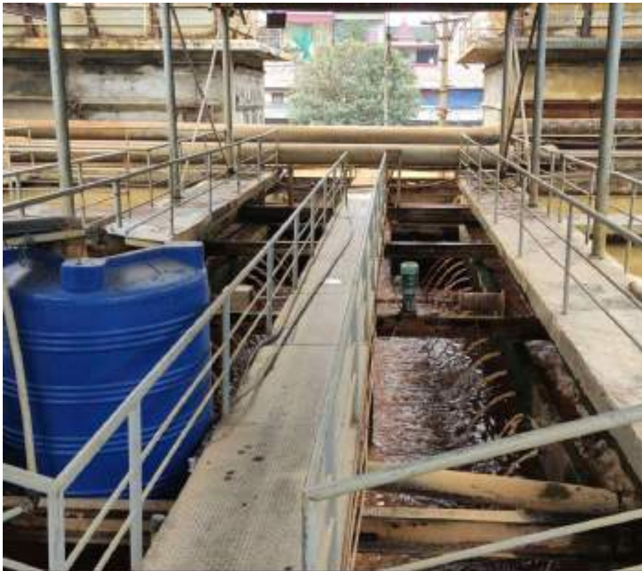
Hình 3.6. Hệ thống xử lý nước thải sản xuất của cơ sở
